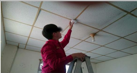
裝設住宅用火災警報器照片
