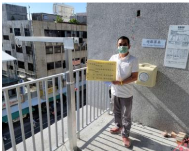
避難逃生器具移位設置照片
